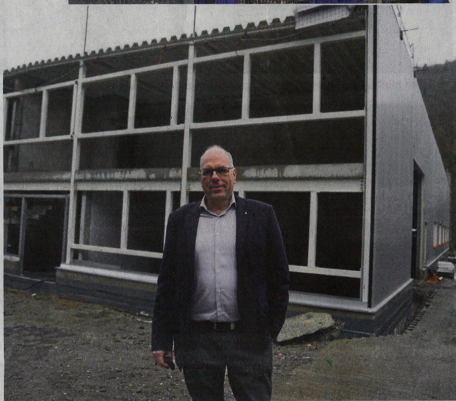
Geschäftsführer Rainer Dieckmann vor der neuen Halle, die am Zweitstandort an der Grüner Talstraße 89 entsteht
